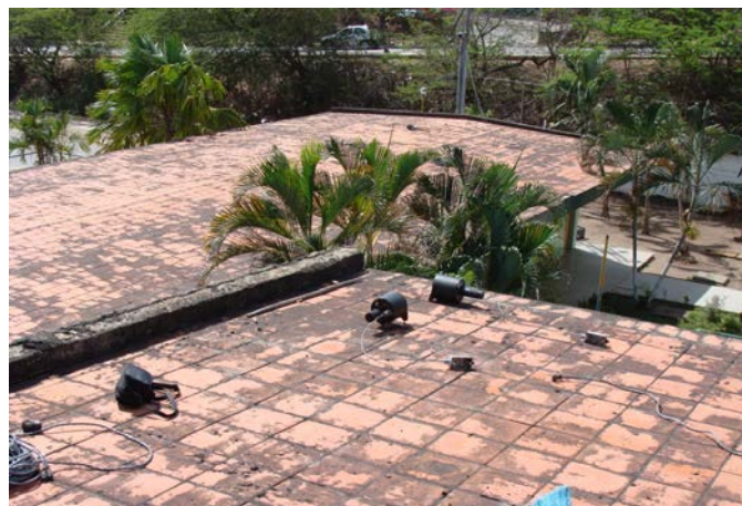
Figura 5.2. 51.- Vista de los sensores Ch 1 y Ch 2
